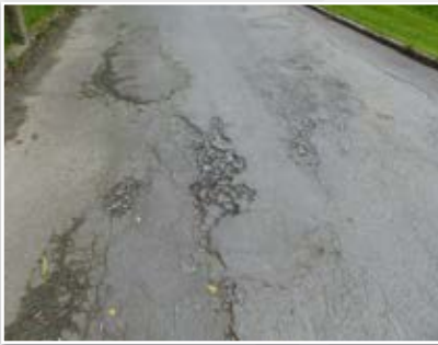
Schadensbild einer Asphaltdecke
