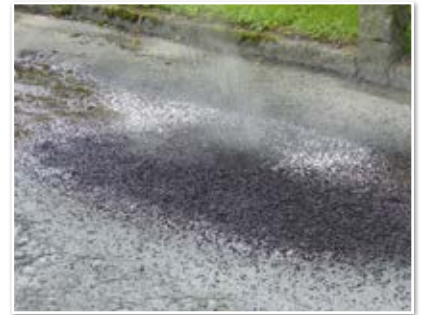
Auffüllen der rissigen Verdrückungen mit Splitemulsionsgemisch
