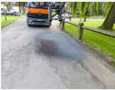
Auffüllen der rissigen Verdrückungen mit Splitemulsionsgemisch
